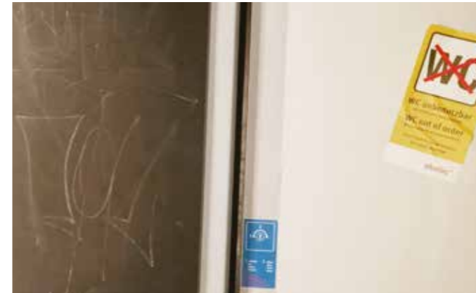
Funktionsmangel einer Toilette
