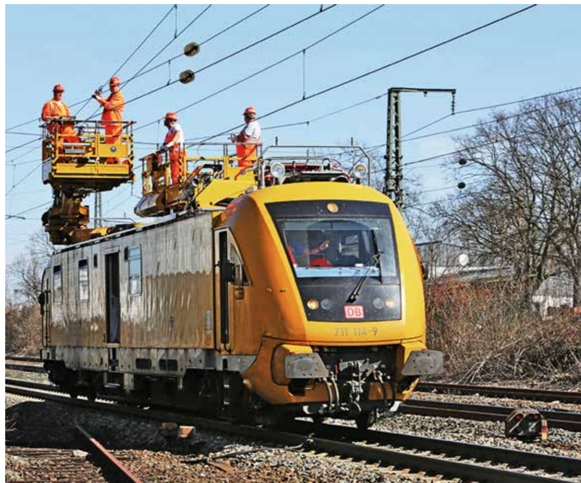
La-Stellen treten häufig aufgrund von Bauarbeiten auf.
